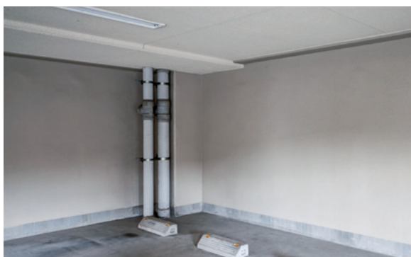
図1-a マンション駐車場 天井使用部
