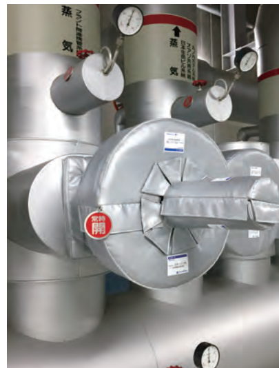
図6 熱供給プラント蒸気ヘッダー弁への取付例 (丸の内熱供給㈱)
