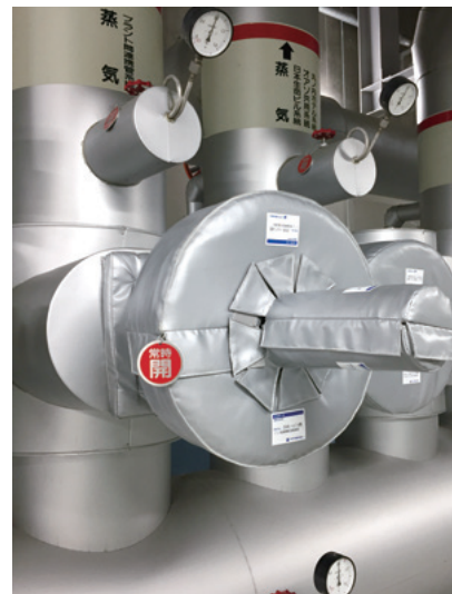
図6 熱供給プラント蒸気ヘッダー弁への取付例 (丸の内熱供給株式会社)
