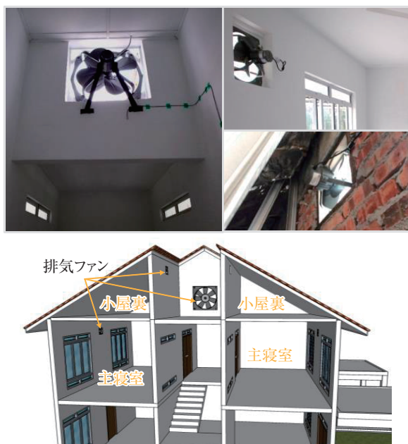
図2 設置した排気ファンとスリット窓
