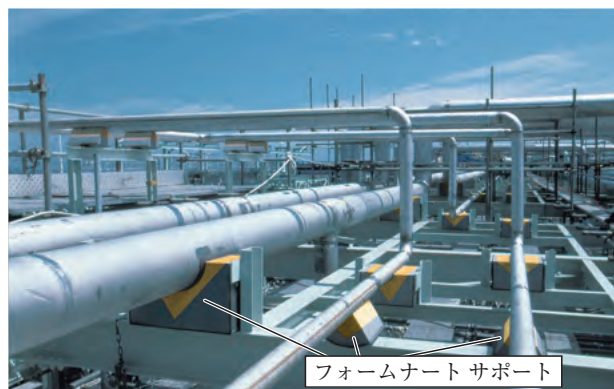
図20 LNG配管に取り付けられた「フォームナート サポート」 (写真は配管に保冷材が施工される前の状況)
