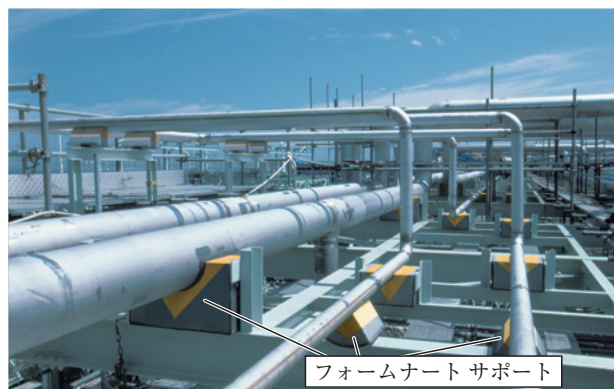
図20 LNG配管に取り付けられた「フォームナート サポート」 (写真は配管に保冷材が施工される前の状況)
