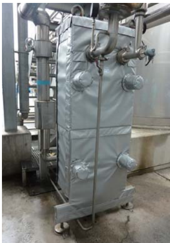
写真4 熱交換器外面への取付例
