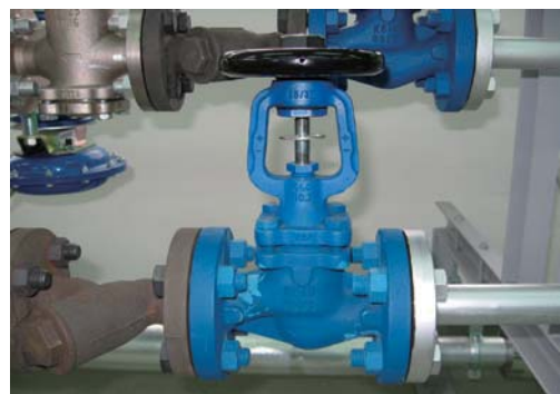
写真1 エネサーモ取付前のバルブ
