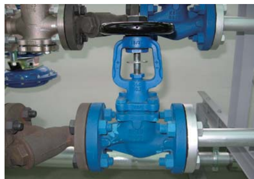
写真1 エネサーモ取付前のバルブ
