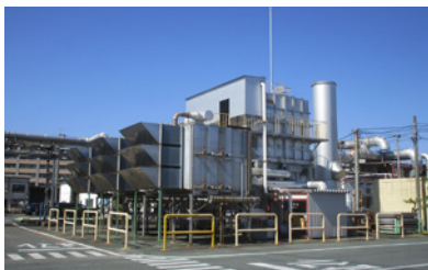
建材工場の脱臭装置
