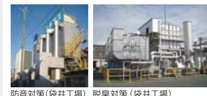
防音対策（袋井工場） 脱臭対策（袋井工場）
