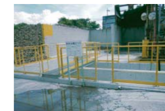
堺ニチアスの沈殿槽
