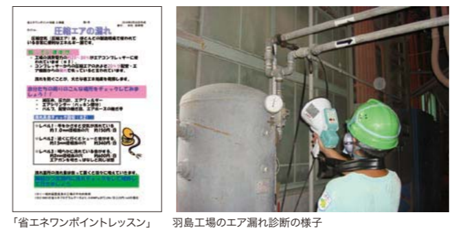
「省エネワンポイントレッスン」 羽島工場のエア漏れ診断の様子
