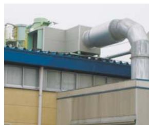
結城工場のサイレンサー
