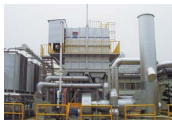
袋井工場の脱臭装置
