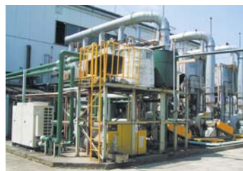
溶剤回収装置
