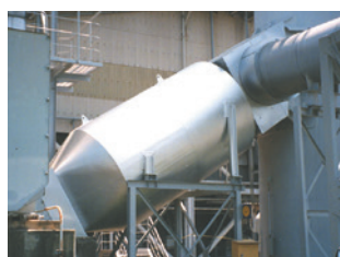
送風機排気サイレンサー
