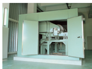
「ニチアス防音パネル」による機械室
