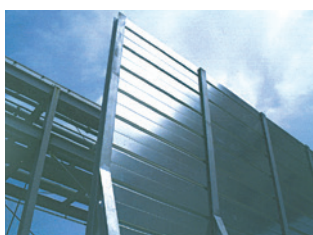
「エコスリットJH」による防音壁
