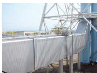
煙道の防音ラギング
