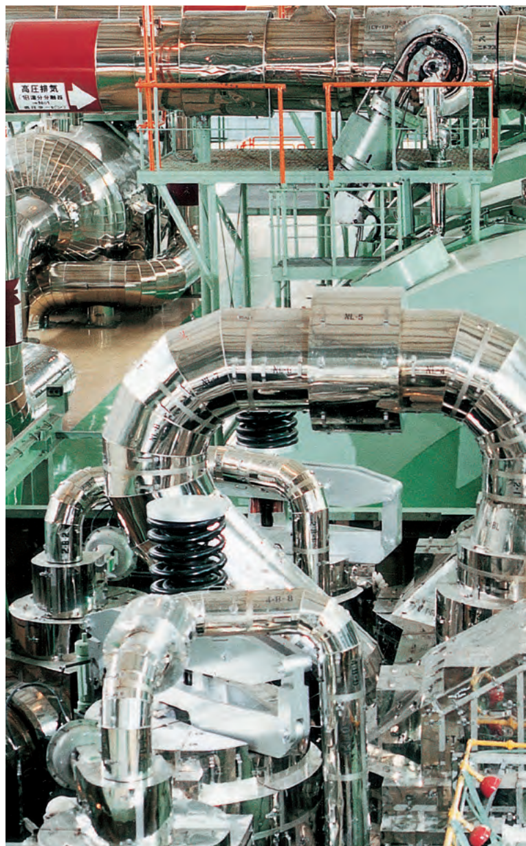
高圧タービン全景
