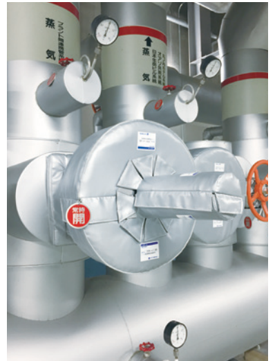
熱供給プラント蒸気ヘッダー弁(丸の内熱供給(株)殿)
