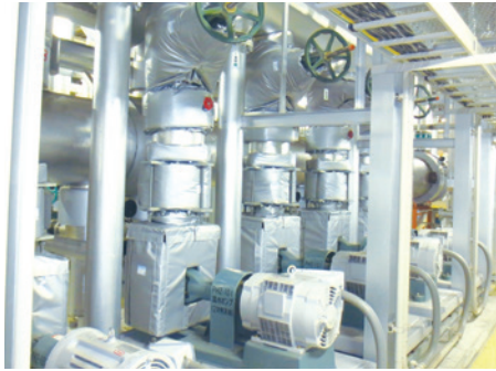
医療センターA 温水ポンプ
