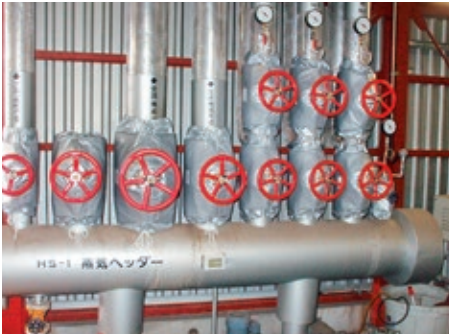
ボイラー室 蒸気ヘッダー廻りのバルブ
