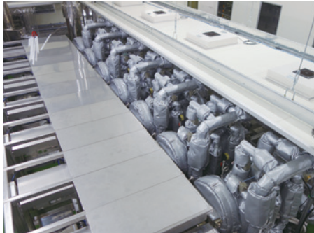
食品製造装置B 本体および配管部
