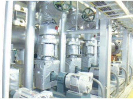
医療センターA 温水ポンプ
