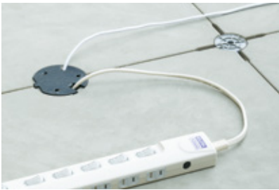
LANケーブル + タップ式コンセント
