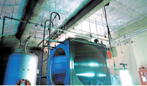
機械室 断熱・吸音
