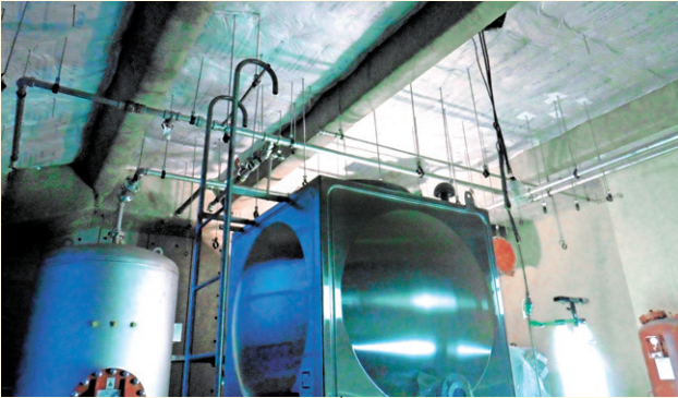
機械室 断熱・吸音
